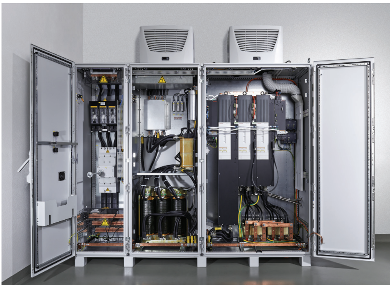
Шкаф управления НМУ
